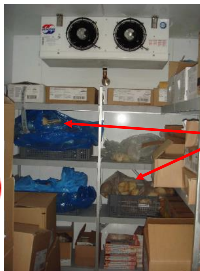
Rangement congélateur NON CONFORME
